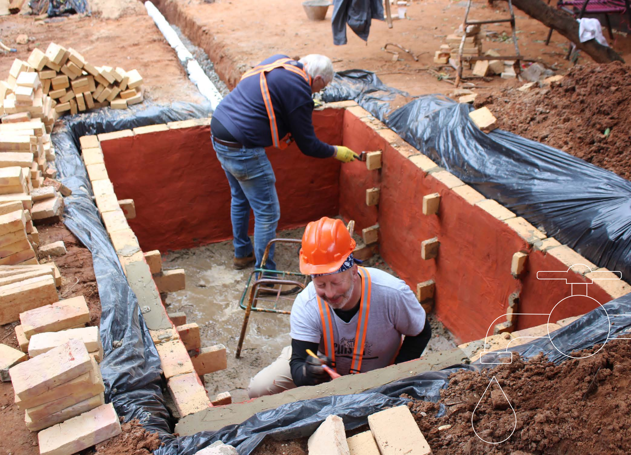
Voluntarios de la Brigada Laura Maltby en proceso de construcción de un baño para una familia de la comunita de Roberto Carlos - Luque
